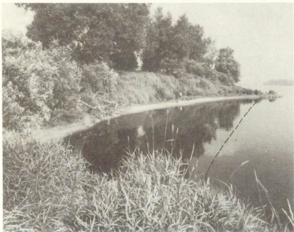
Fot. 20. Brzeg poregulacyjny koryta Wisły powyżej Torunia (Brzoza Toruńska) niszczone na skutek „dziczenia” rzeki (zniszczona zabudowa hydrotechniczna). Linią przerywaną oznaczono maksymalny zasięg linii brzegowej poregulacyjnej.
