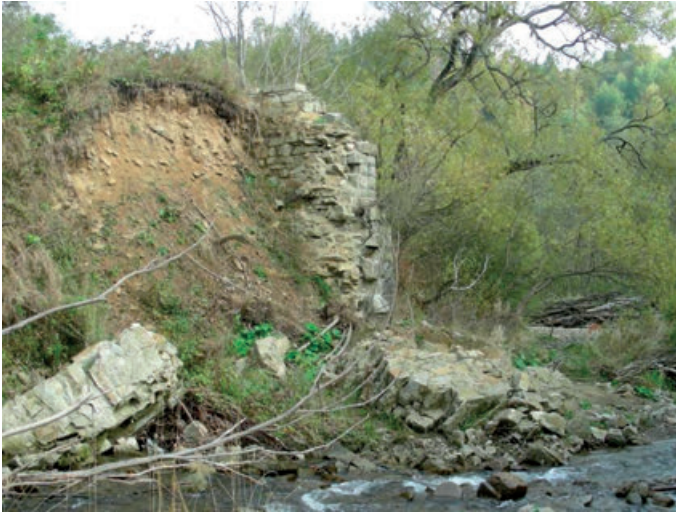
Ryc. 33.11. Zniszczony przyczółek mostu nad Roztokami w Tarnawie Niższej (fot. J. Kukulak)
