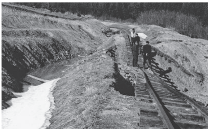
Ryc. 38.7. Nasyp kolejki w Przysłupiu zniszczony w wyniku opadów deszczu (Archiwum RDLP w Krośnie, 1957)
