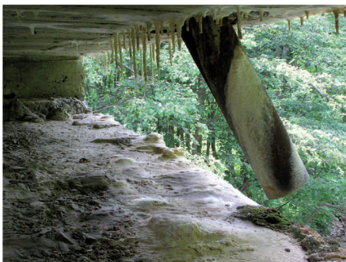
Ryc. 43.16. Nacieki wapienne na niszczącym betonowym moście w Wetlinie (fot. G. Haczewski)
