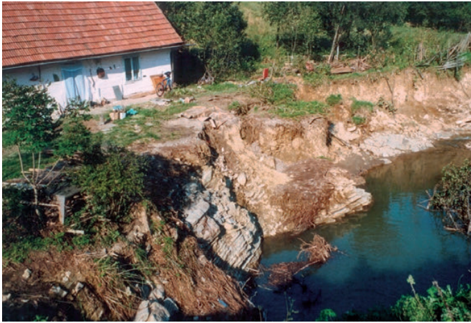
Ryc. 7.9. Potok Cisowiec (dopływ Hoczewki) poniżej przepustu drogowego – pogłębienie koryta i podmycie krawędzi terasy w wyniku ulewy w dniu 26.07.2005 r. (fot. L. Starkel, 2005)
