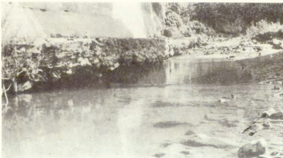
Fot. 2. Zawieszono nad dnem koryta Kamienicy Nawojowskiej fundamenty filaru mostu drogowego Zdjęcie wykonane po przejściu fali powodzi 19 - 23 VII 1970
