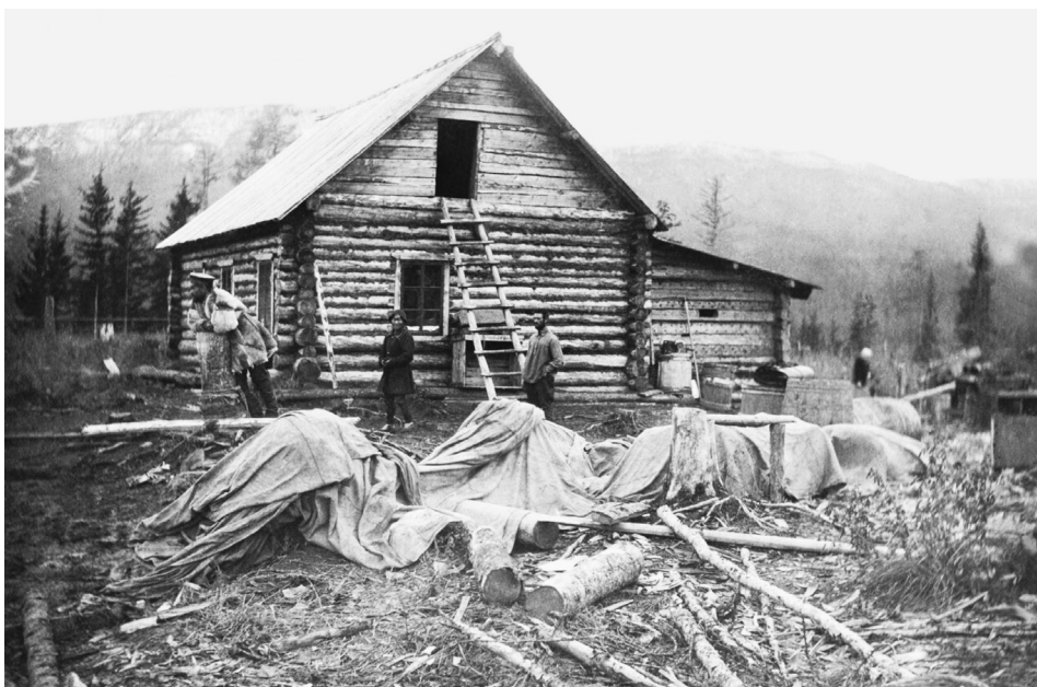
Zdjęcie nr 1. Budowa nowej faktorii w Wiwi, Dolna Tunguzka. Zdjęcie wykonane przez Nikolaia P. Naumova, najprawdopodobniej w kwietniu 1927 (artykuł zacytowany na początku tego tekstu został napisany czternaście lat po zrobieniu tej fotografii). Źródło: www.abdn.ac.uk/polarcensus/Naumov.htm (KKKM 7930-1-05-02).
