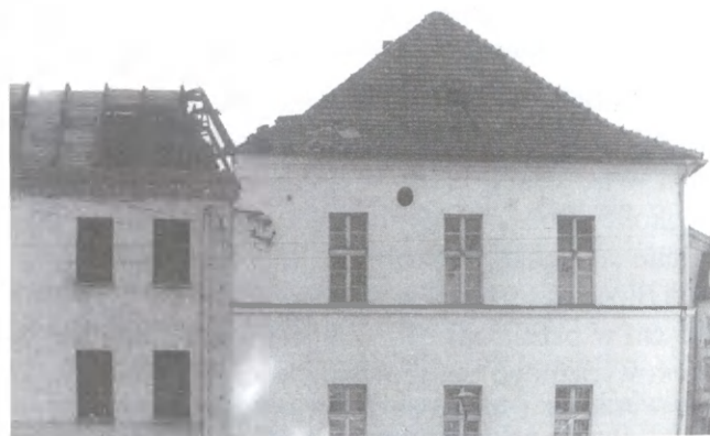
Ryc. 2. Widok remontowanego budynku, w którym znajdowała się płaskorzeźba Abb. 2. Ansicht des renovierten Hauses, Fundstelle des Reliefs
