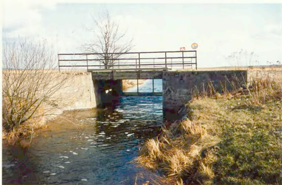
Fot. 6. Zastawka na wypływie Rakutówki z jeziora w czasie upustu wody The weir on the Rakutówka outflow from the lake during water sluice http://rcin.org.pl
