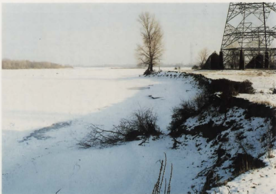
Fot. 10. Nisza erozyjna na lewym brzegu Wisły przy słupie linii energetycznej 400 kV na Kępie Semplawskiej. Odległość od narożników słupa do krawędzi brzegu wynosi 18 m. Widok w górę rzeki. 01.02.1996
