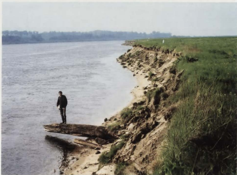
Fot. 23. Erozja prawego brzegu w Mątowach Małych (ryc. 23). 15.05.1997
