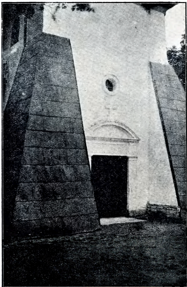
Fig. 17. Fragment kościoła parafjalnego w Skierbieszowie. Przykład ujemny zastosowania blachy do pokrycia skarp.
