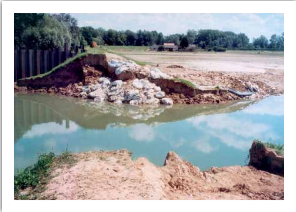
Fotografia 4.14. Wał przeciwpowodziowy przerwany w czasie powodzi w 2010 roku w dolinie Wisły na przedpolu Karpat; misa eworsyjna i rozległy stożek krewasowy
