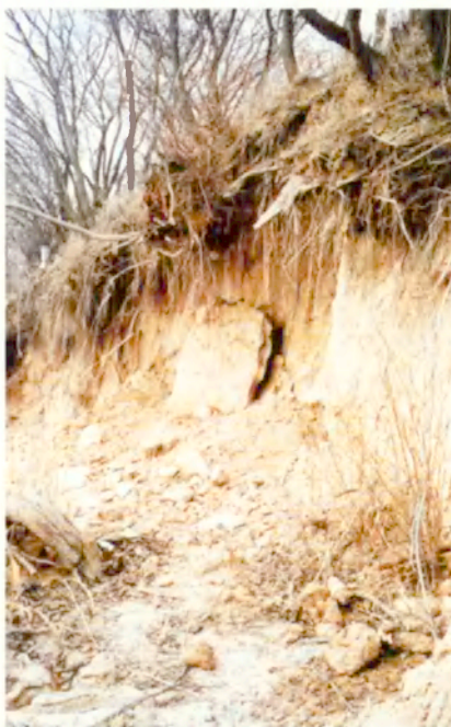
Fot. 19. Obryw górnej części klifu, Kołuda Mała
