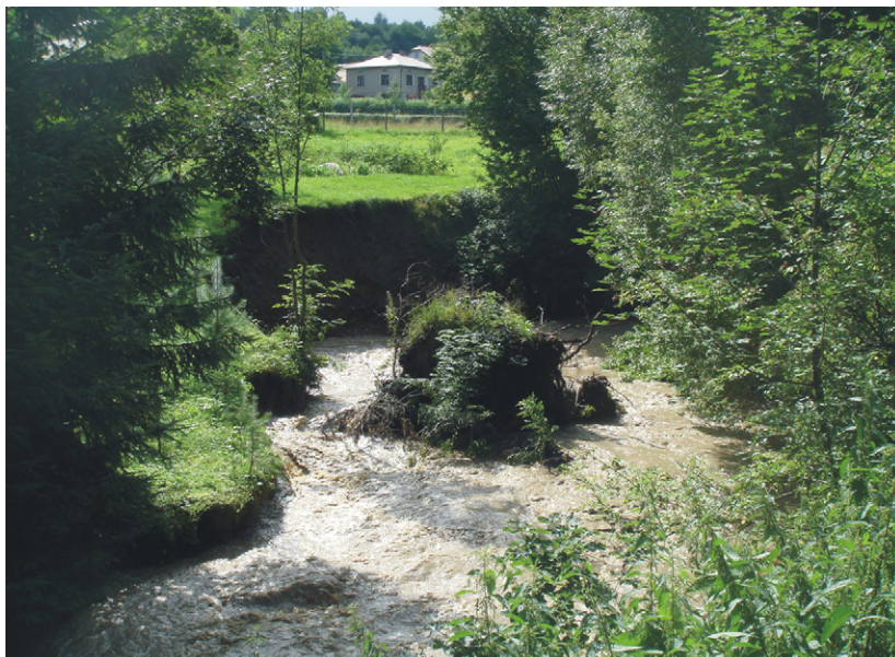
Fot. 10. Fragment prawego brzegu oderwany wskutek rozlewnych opadów deszczu i zmian przepływu wody w 2011 r.
