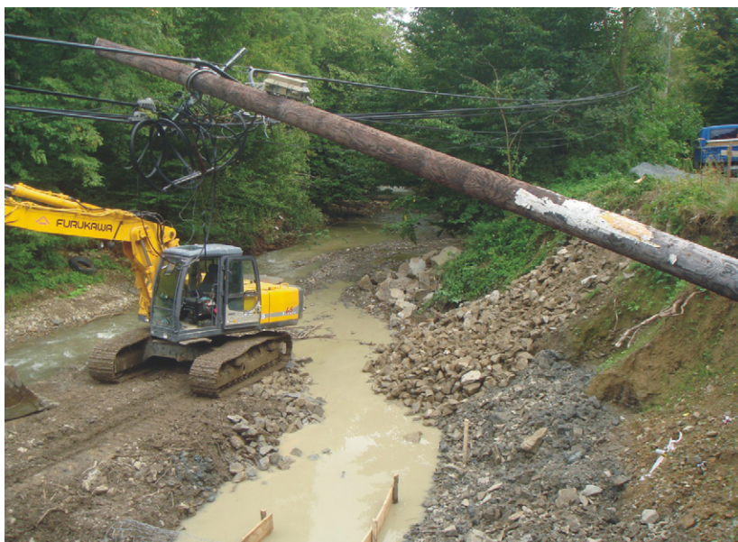
Fot. 11. Prace inżynierskie w korycie Bystrzanki prowadzone we wrześniu 2010 r. z użyciem ciężkiego sprzętu zmechanizowanego, w celu umocnienia erodowanego brzegu wzdłuż drogi powiatowej podciętej w czerwcu 2010 r.
