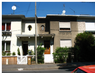
Fot. 20. Budynek odnowiony i nieodnowiony z 1933 roku (rejon cité-jardin basse) Refurbished and not renewed building from 1933 (cité-jardin basse area)
