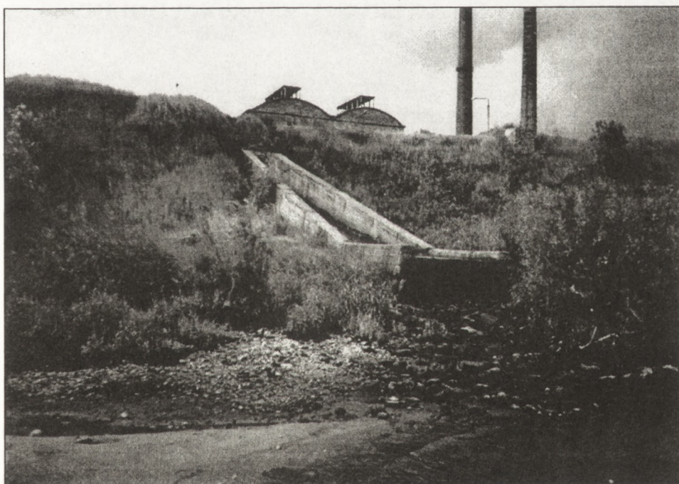
Fot. 9. „Zawieszono” na skutek procesu erozji wgłębnej ujście wód z ZCiP do Wisły
