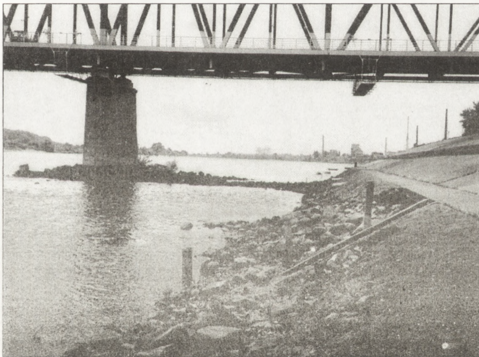
Fot. 5. Niszczone umocnienia betonowe lewobrzeżnego bulwaru we Wrocławku, a także mostu drogowego
