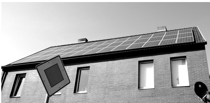
Fot. 1. Instalacja fotowoltaiczna na dachu (fot. K. Kurowska). Photovoltaic system on the roof.
