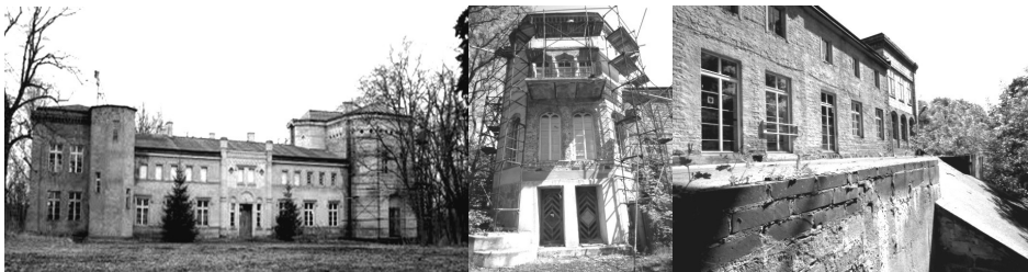
Fot. 1. Zdewastowana elewacja zabytkowego pałacu w Lusowie od lat bezskutecznie remontowana (fot. M. Szczepańska).
