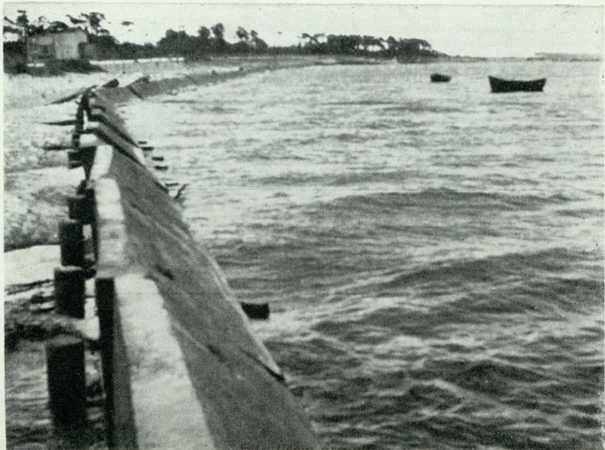
34. Kuźnica — Zatoka Pucka. Niszczenie na brzegu opaski betonowej przez sztorm. Widoczne zwichrowanie bloków betonowych. 1960.
