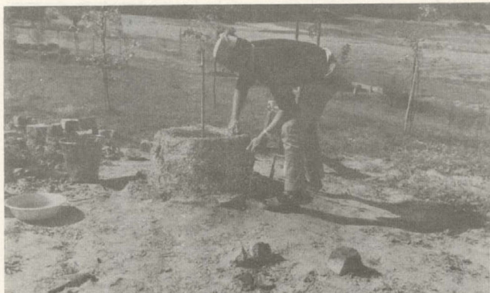
Ryc. 11. Nowa Słupia, gm. Nowa Słupia, woj. Kielce. Początkowy etap budowy szybu pieca dymarskiego nad kotlinką (1962). Fot. K. Bielenin
