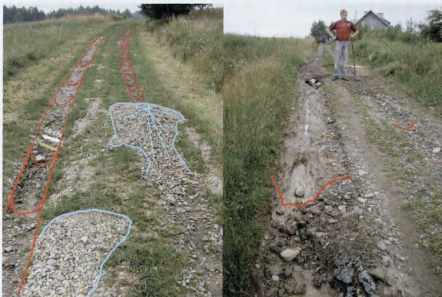
Fot. 3. Zniszczone drogi w zlewni Zalasówki po opadzie w dniu 27.06.2009 (kolor czerwony – erozja, niebieski – akumulacja)
