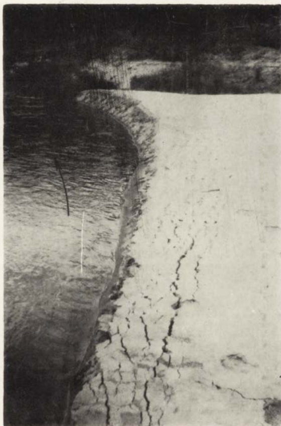
Fot. 34. Osiadanie niskiej kra- wędzi łąchy Jäkälämutka Low edge destroyed mainly by infiltration and subsidence
