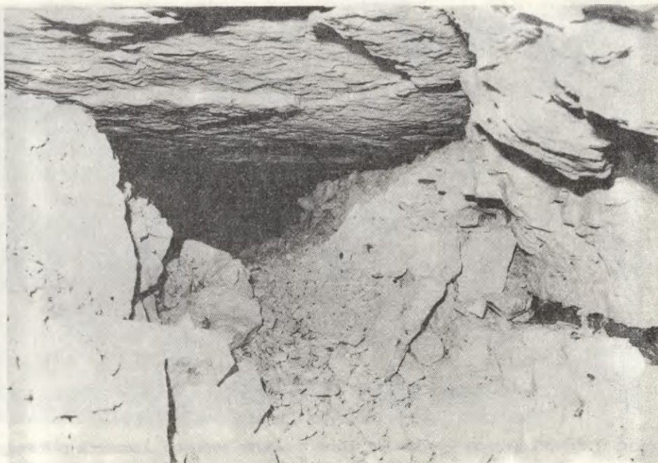
Ryc. 6. Chodnik 1a – widok od strony przodka górniczego Gangway 1a – view from the mine face
