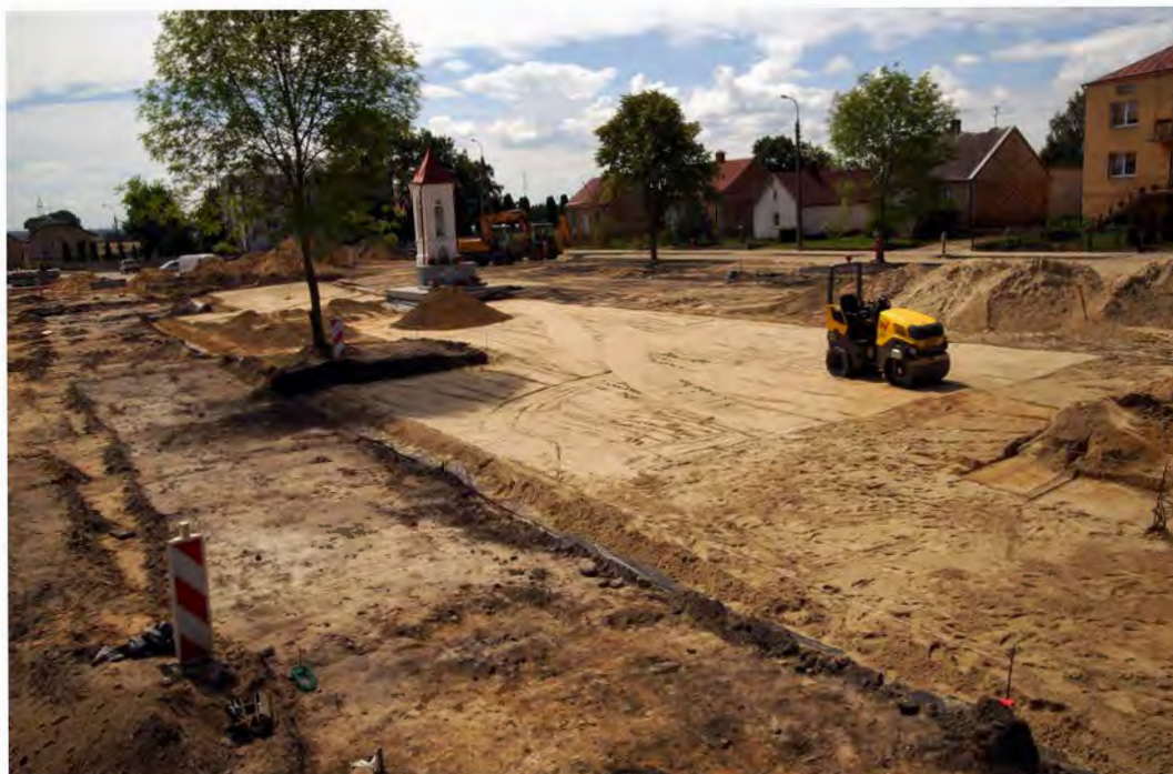
Ryc. I.12. Suraż, stan. 2 i 7. Prace budowlane na terenie rynku (widok od północnego wschodu). Lipiec 2018 r. Fot. D. Krasnodębski
