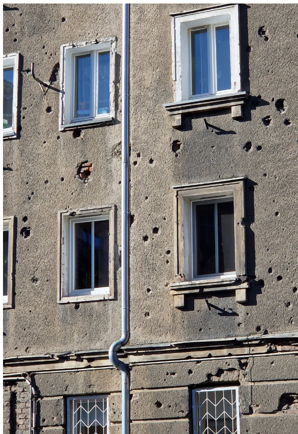
Fot. 3. Wrocław, ślady postrzałów z okresu II wojny światowej w ścianie kamienicy przy ul. Ustronie. Fot. J. Krajewska, 2024.
