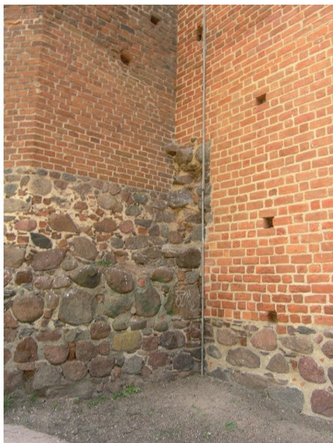
Ryc. 23. Zamek w Kruszwicy, kamienna partia okrągłej Mysiej Wieży. Rozebrany materiał ze starej wieży został wykorzystany w dolnej partii nadbudowanego, ceglanego ośmioboku. Na styku z murem obwodowym widoczny jest jednak fragment sprutej partii muru do której dostawiono kurtynowy mur zamkowy. Fot. M. Małachowicz
