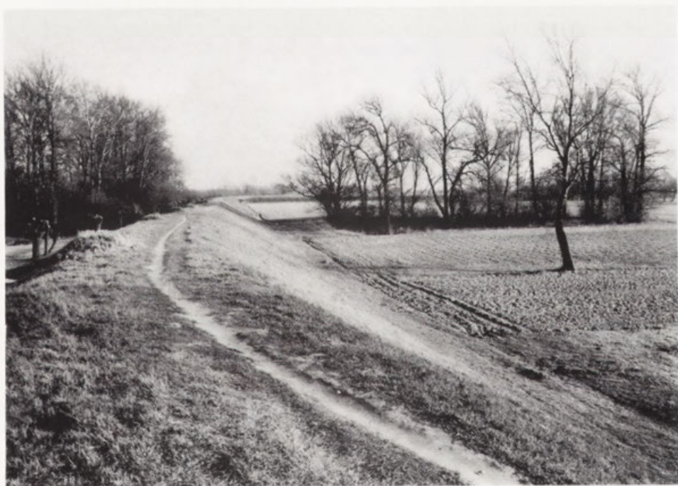
Fot. 34. Zabezpieczający „Nizinę Ciechocińską” wał powodziowy. W km 711,5 widoczny zadrzewiony wybój (po prawej stronie) na wypadzie wyrwy w wale powstałej podczas wezbrania zatorowego w marcu 1924 r.
