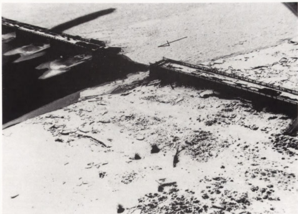
Fot. 50. Zniszczona podpora mostu i zerwane dwa przęsła mostu w Wysogrodzie w okresie pochodu lodu w dniu 20 lutego 1987 r. (porównaj ryc. 48). Zdjęcie lotnicze.
