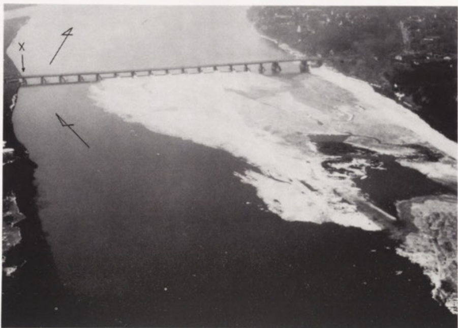
Fot. 52. Efekt przegrody lodowej obserwowany na konstrukcji mostu drogowego w Wyszogrodzie (marzec 1986). Strzałką oznaczono „zimowe” położenie nurtu (zimowa inwersja nurtu, por. ryc. 46), będąca główną przyczyną awarii mostu 20 lutego 1987 r. (porównaj ryc. 48, fot. 50). Zdjęcie lotnicze.
