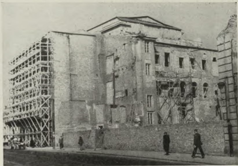
67. Pałac Staszica — ściana południowa w czasie przebudowy i ściana zachodnia w czasie robót elewacyjnych w 1948 r.
