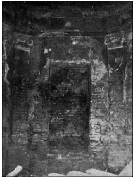
5. Wnętrze budynku znajdującego się dawniej na tyłach Pałacu Staszica oraz wnęka uznana przez Tadeusza Prusa-Faszczewskiego za pozostałość po ołtarzu
