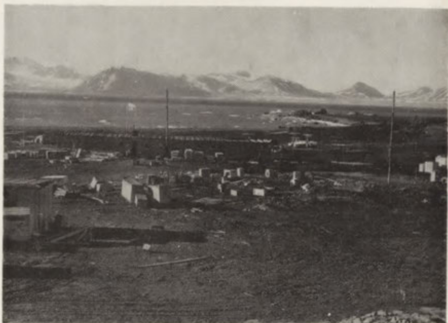
Fot. 3. Prace remontowe w Stacji Polarnej — lipiec 1978 r. (Fot. M. Górski) Repair work in the Polar Station — July 1978
