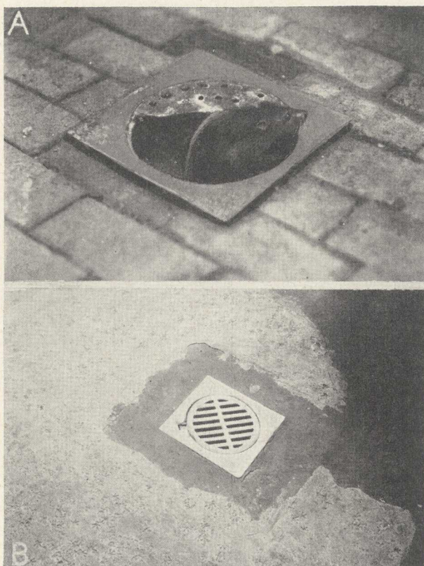
Figure 12.—A, une grille d'égout endommagée est pour les rats une voie d'accès toute trouvée; B, les traces laissées par les pattes des rats dans le ciment encore humide montrent clairement qu'avant l'installation de la nouvelle grille, l'égout servait aux rats de grande route.
