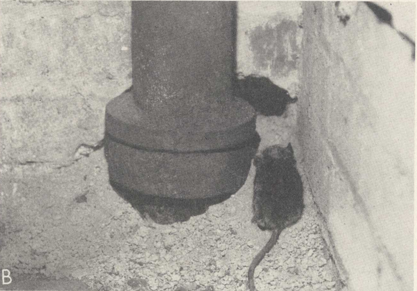
Figure 13.—A, les ouvertures autour des tuyaux sont autant de portes d'entrée pour les rats; B, des aménagements de cette nature permettent aux rats de s'introduire dans des bâtiments qui, autrement, seraient à l'épreuve des rats.
